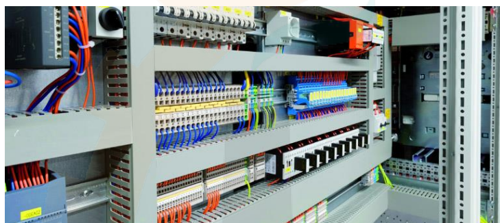
نمایی از یک تابلو برق صنعتی
