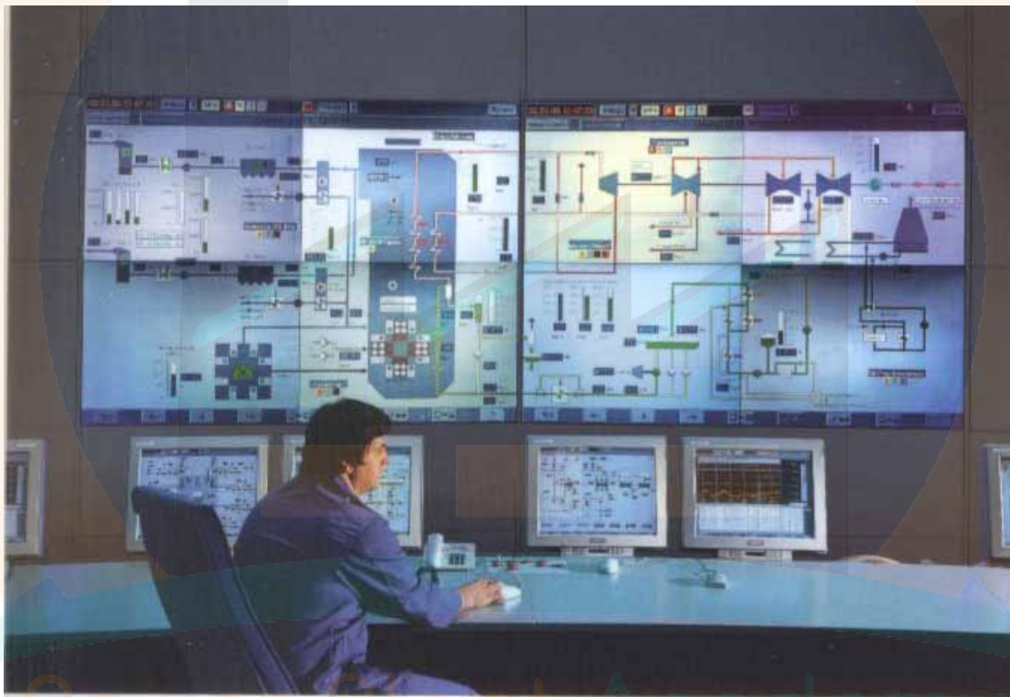
اتاق کنترل یک نیروگاه سیکل ترکیبی در آلمان
