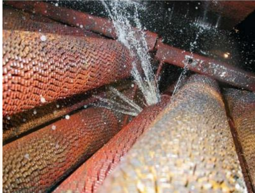
خوردگی ناشی از کندانس محصولات اسیدی در لوله های اکونومایزر
